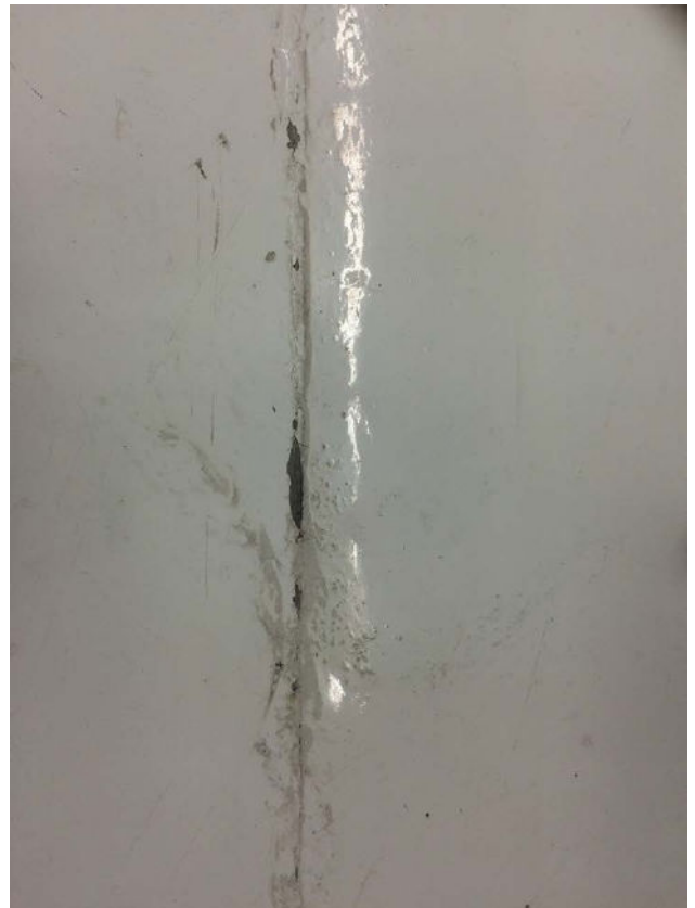
Figura 1: Imprimación negra expuesta en piso ESD Gen 2 debido a daños por impacto
